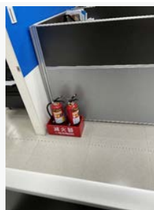
辦公座位區設置 之滅火器實景
