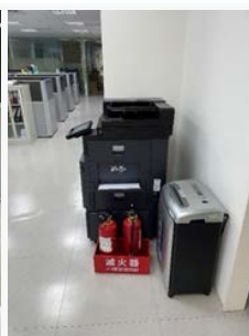
影印機與碎紙區 消防器材配置現況
