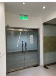
辦公室出入口 逃生標示設置
