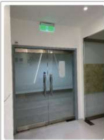
辦公室出入口逃生標示設置
