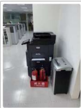
影印機與碎紙區 消防器材配置現況
